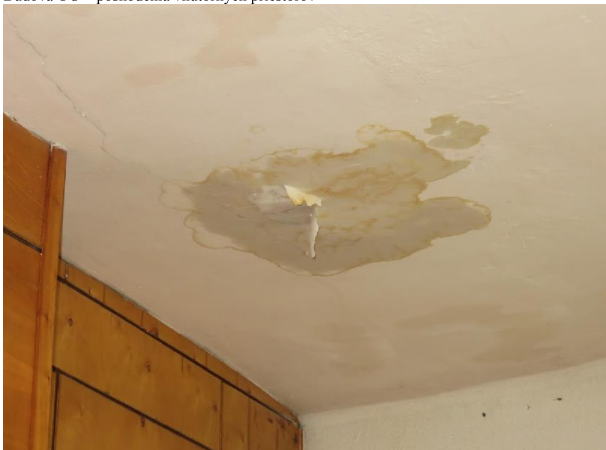
Budova OÚ – poškodenia vnútorných priestorov
