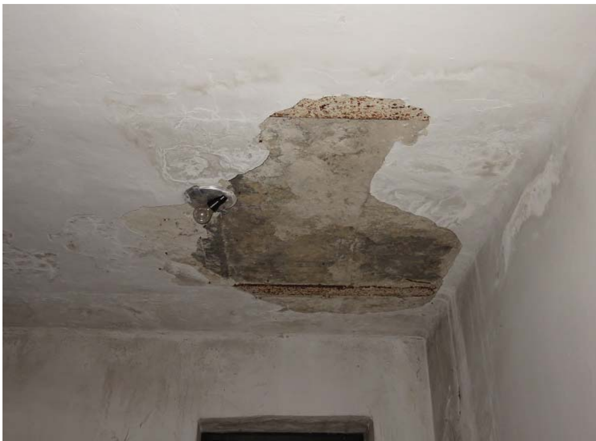
Budova bývalého KaSS – poškodenie interiéru vplyvom zamokania
