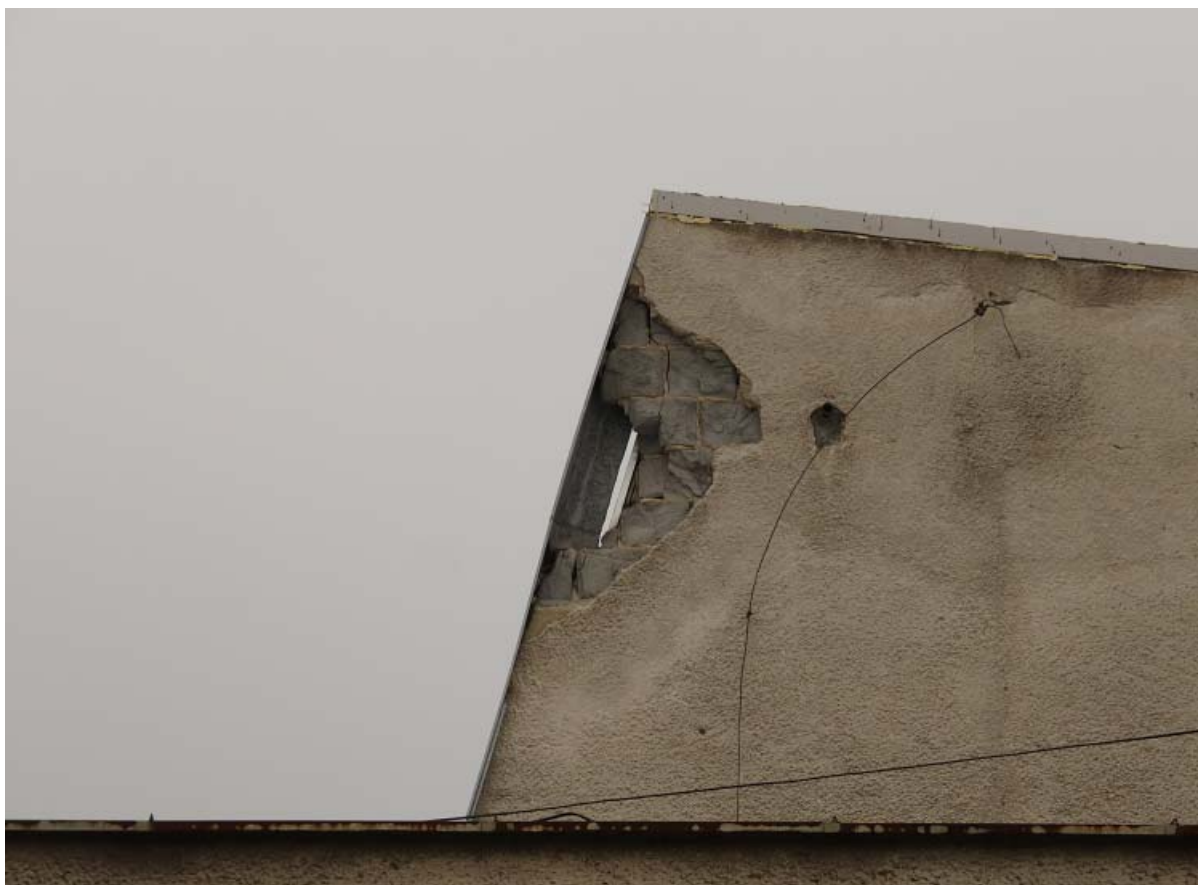
Budova plavárne – rekonštrukcia strechy bez opravy atikových múrikov
