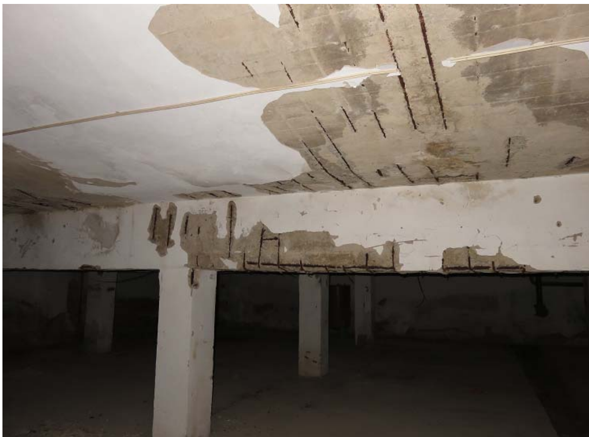
Budova plavárne – narušený nosný systém pod bazénom
