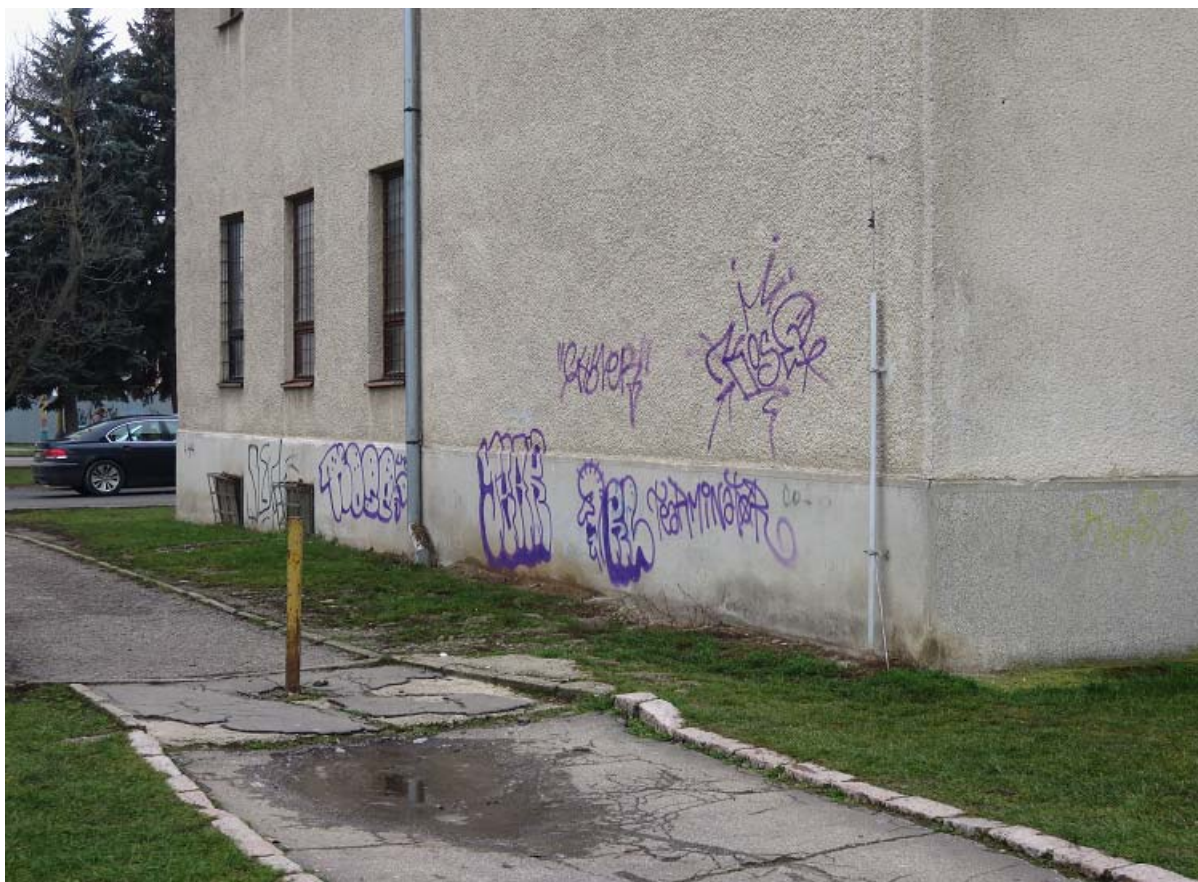
Budova bývalého KaSS – početné grafity na fasáde
