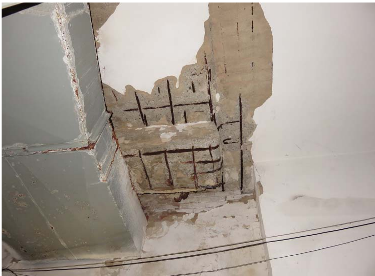
Budova plavárne – porušené železobetónové konštrukcie
