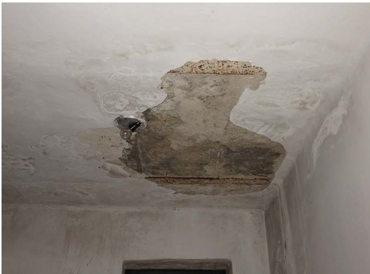
Budova bývalého KaSS – poškodenie interiéru vplyvom zamokania
