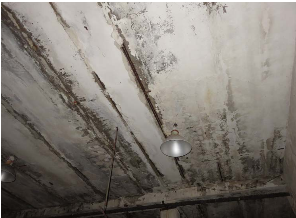
Budova plavárne – porušené železobetónové konštrukcie
