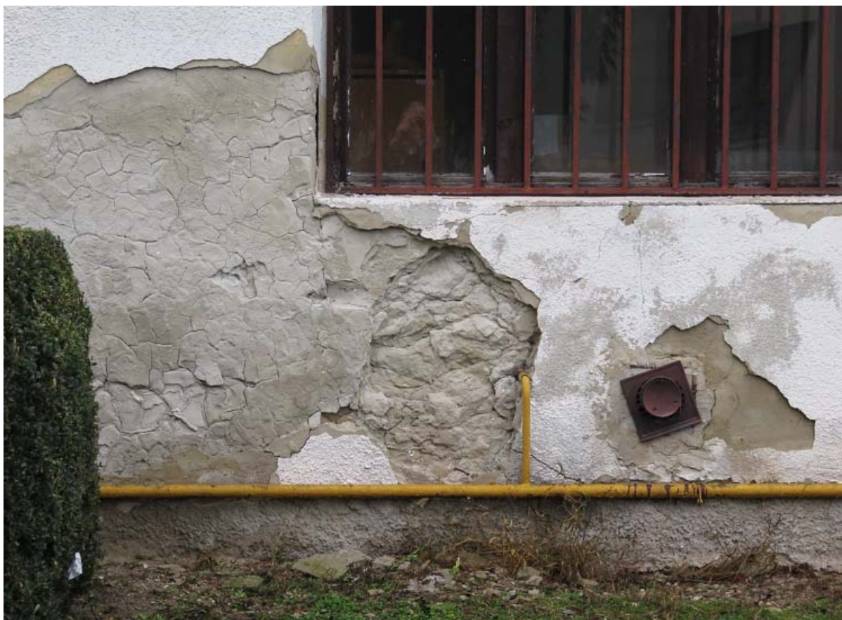
Budova bývalého CVČ – poškozené omietky
