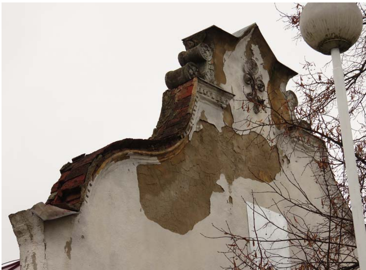
Budova bývalého CVČ – chýbajúce oplechovanie atiky, poškodená fasáda
